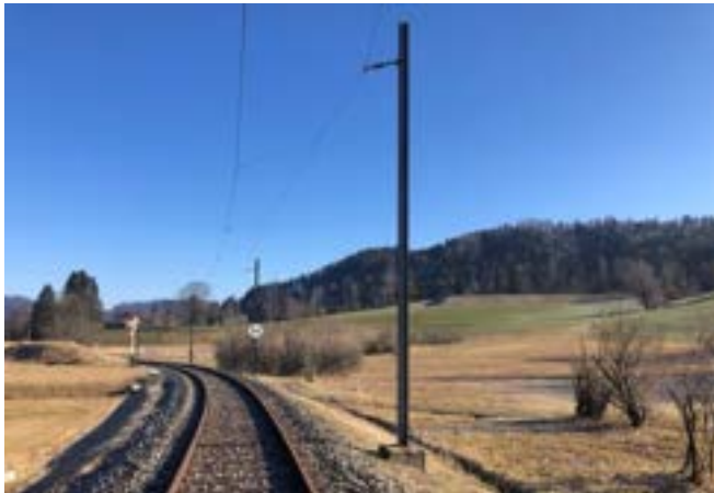
Windschiefe Fahrleitung im Netzteil Zürich
